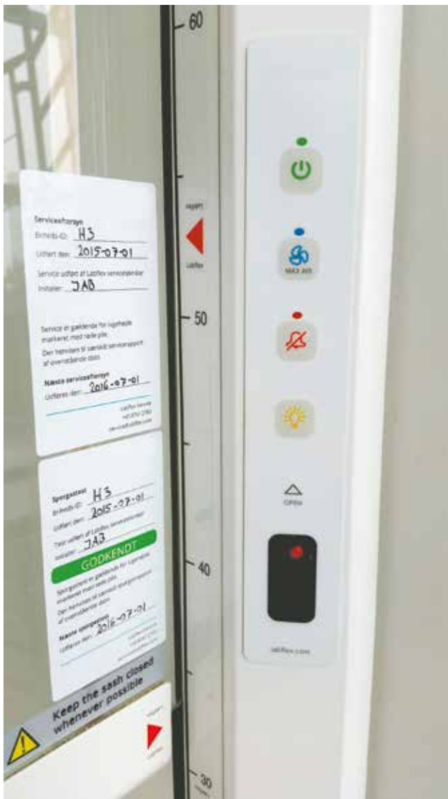
Billede 10 Eksempel på dokumentation af udført service samt sporgasmåling på et stinkskab. De røde pile på hhv. lugen samt stinkskabets side indikerer den maksimale lugehøjde hvor service og sporgastesten er gældende.
